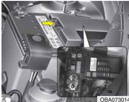
Panel de fusibles del compartimento del motor
